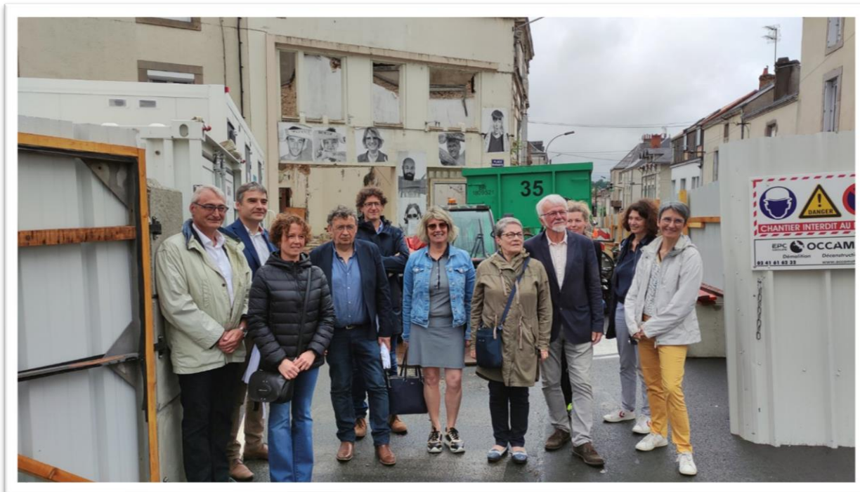
PHOTO /CO.DONATIEN MILLET. Lancement des travaux de démolition de l'ancien théâtre de Bressuire en présence de l'agglo 2 b, la ville de Bressuire, deux sèvres-habitat, Bogage et l'équipe d'architecte.
